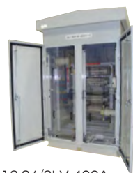
13.8/√3kV 400A 19.9Ω 10秒
