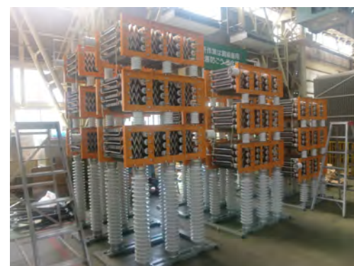
154/√3kV 300A 296.4Ω 10秒
